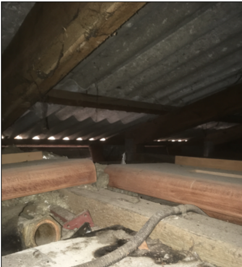
Слика 6. Кровна покровка која садржи азбест (фото: С. Сушић)
